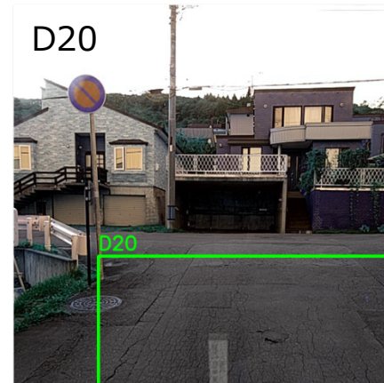
亀甲状ひび割れ
